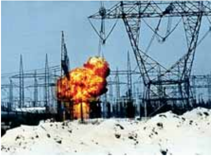
Взрыв обычного измерительного трансформатора.
